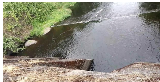
Imagen 1. Aliviadero de Tormenta Parque Chuyaca.
